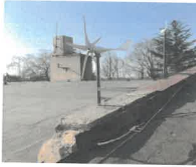
Veterné turbíny t.č. nie sú prevádzke z technických príčin umiestnené na streche vlastnej budovy
