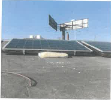
Fotovoltaické panely:59 kusov. v prevádzke
